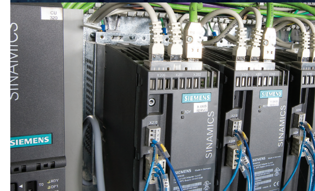
■ SIEMENS SERVO CONTROLLERS
